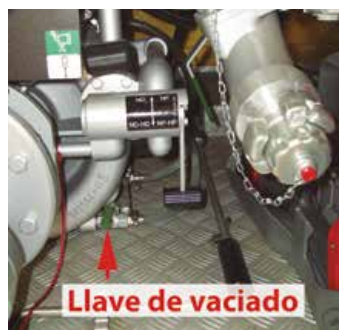
Figura nº 49. Llaves de vaciado
