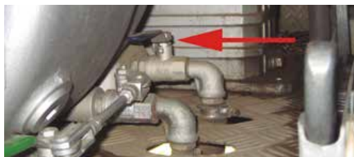
Figura nº 50. Llave del circuito de refrigeración del motor
